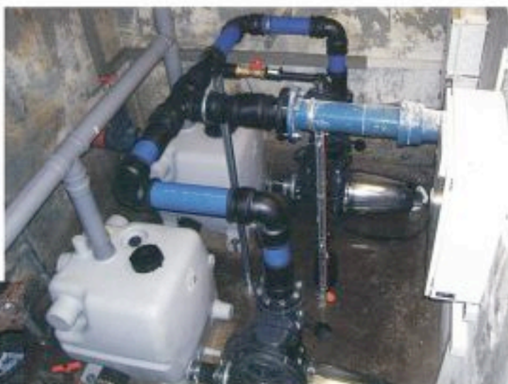
NEU - Installation mit GRUNDFOS - Sonderanlage
